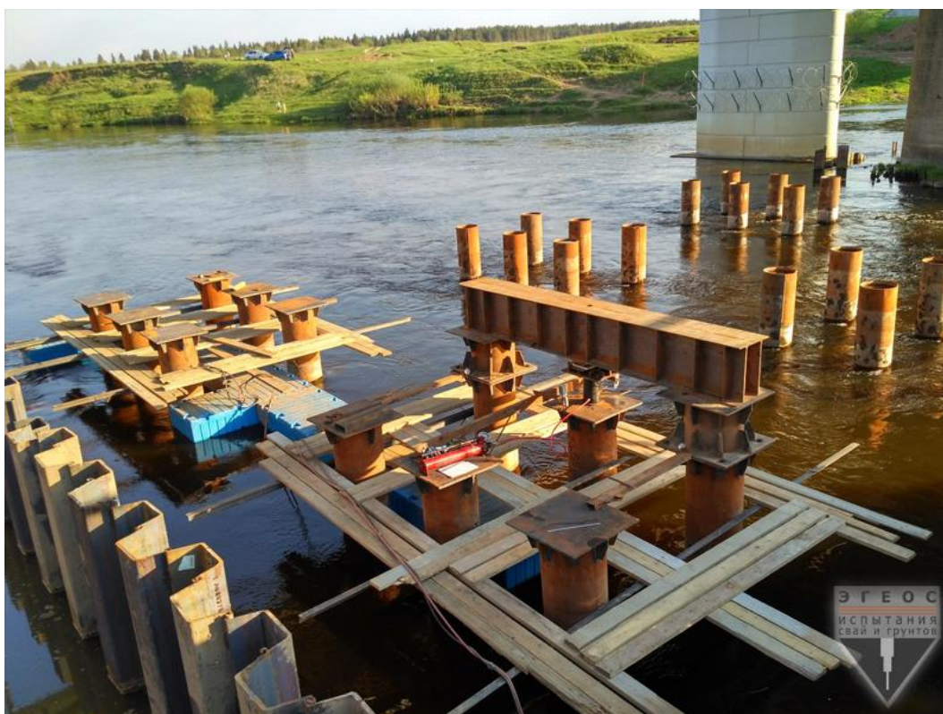
Испытательный стенд ООО «ЭГЕОС», Национальный парк «Угра»
